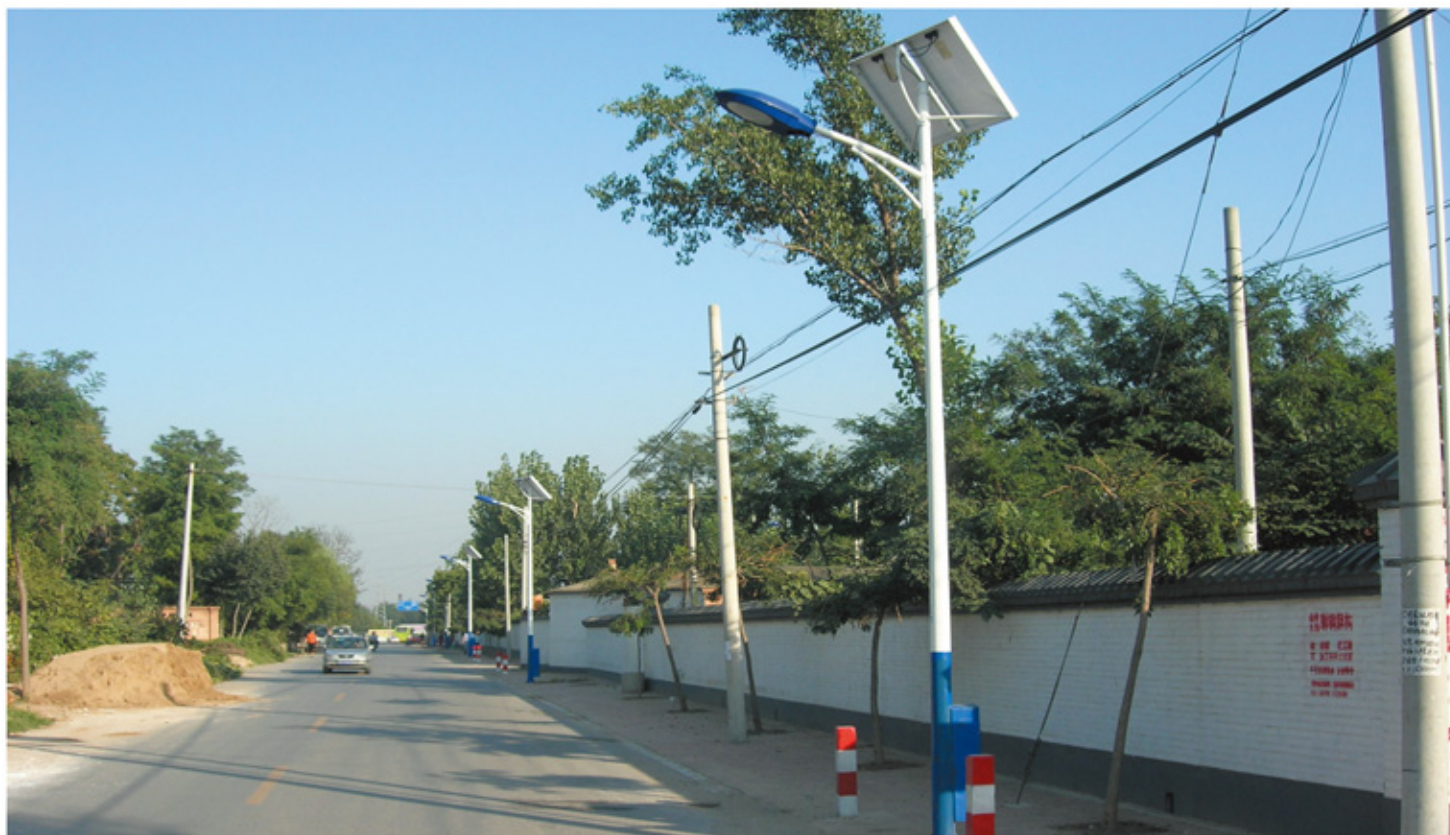
房山区賢店镇の太陽光照明
