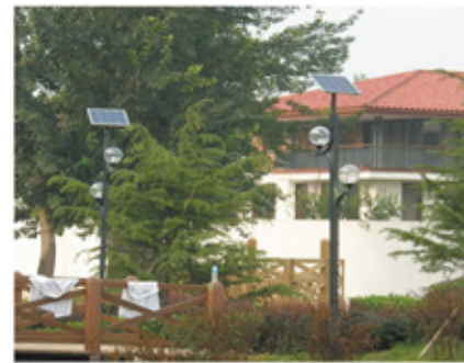
光電総局542所の太陽光庭園照明
