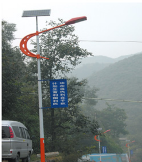
房山区南窯郷の太陽光照明
